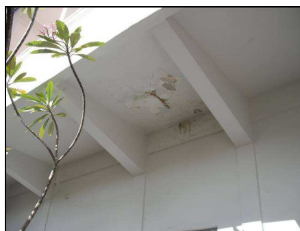
Figura 5: Vista de baixo da laje.
